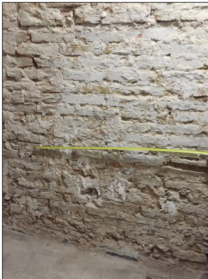
Fig. 21. Mur de maó de diverses mides i argamassa de bona factura en la tercera planta de la finca del carrer de la Palla, 33-35.
