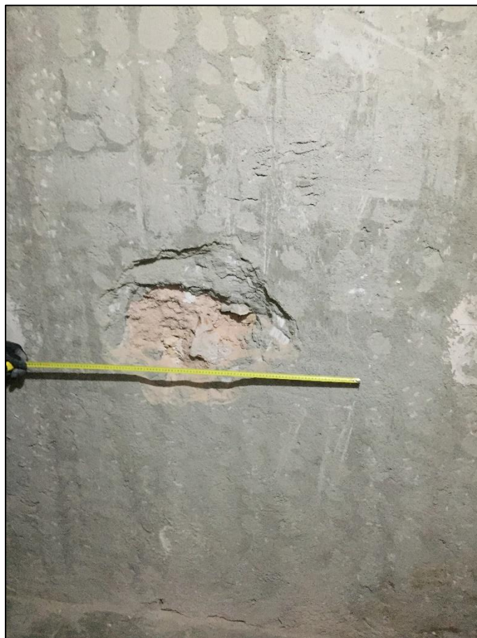
Fig. 20. Petit sondeig en el mur que separa les dues antigues finques números 33 i 35 del carrer de la Palla, en la seva planta primera.
