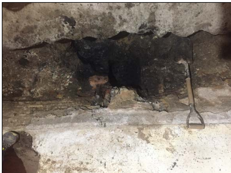
Fig. 18. Punt d'unió de les diverses clavegueres que circulaven per la zona on es realitza el forat de l'ascensor. Sedimentació alterada per al presència de les clavegueres i el punt d'unió entre elles (UE 34).
